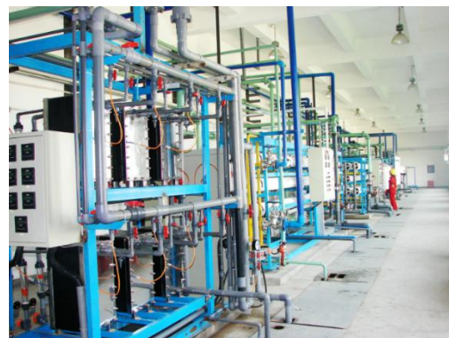
6 m 3 /h “UF/ROEDI” 集成一体式设备 (河北衡水某玻璃镀膜企业)
