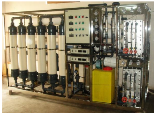
20 m 3 /h “UF/RO/RO/EDI” 锅炉补给水工程 (银川哈纳斯天然气发电厂)
